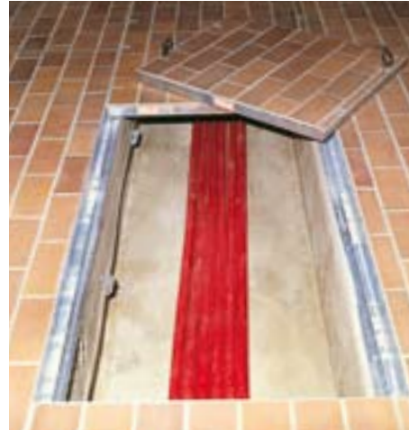
Riviluukku kaapelikanavaan asennettuna.
